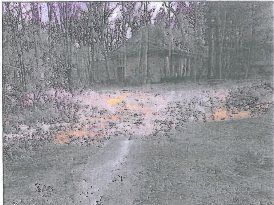
Abb. 4 Ruine der Isolierstation, Blick von Süden
