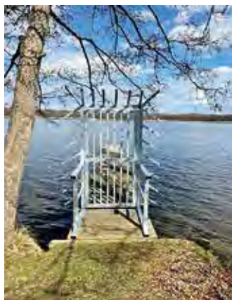
Stegsicherung an der Badestelle des Strandbades Kallinchen
