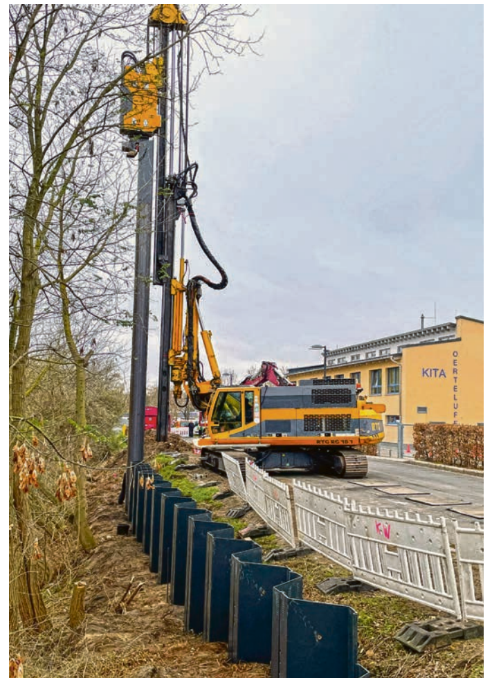
45 Tonnen Stahl verteilt auf jeweils 13 Meter lange Einzelemente sollen die Straße am Oertelufer befestigen. Gleichzeitig werden der Fußweg erneuert und ein Geländer angebracht. Foto: Stadt Zossen
