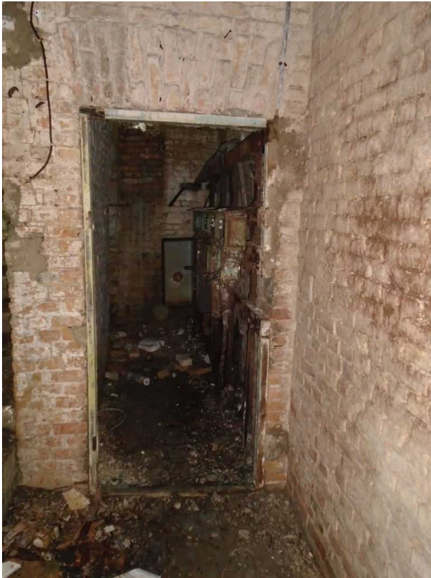
Abbildung 8 Innenraum mit Technik (Foto: EWZ)
