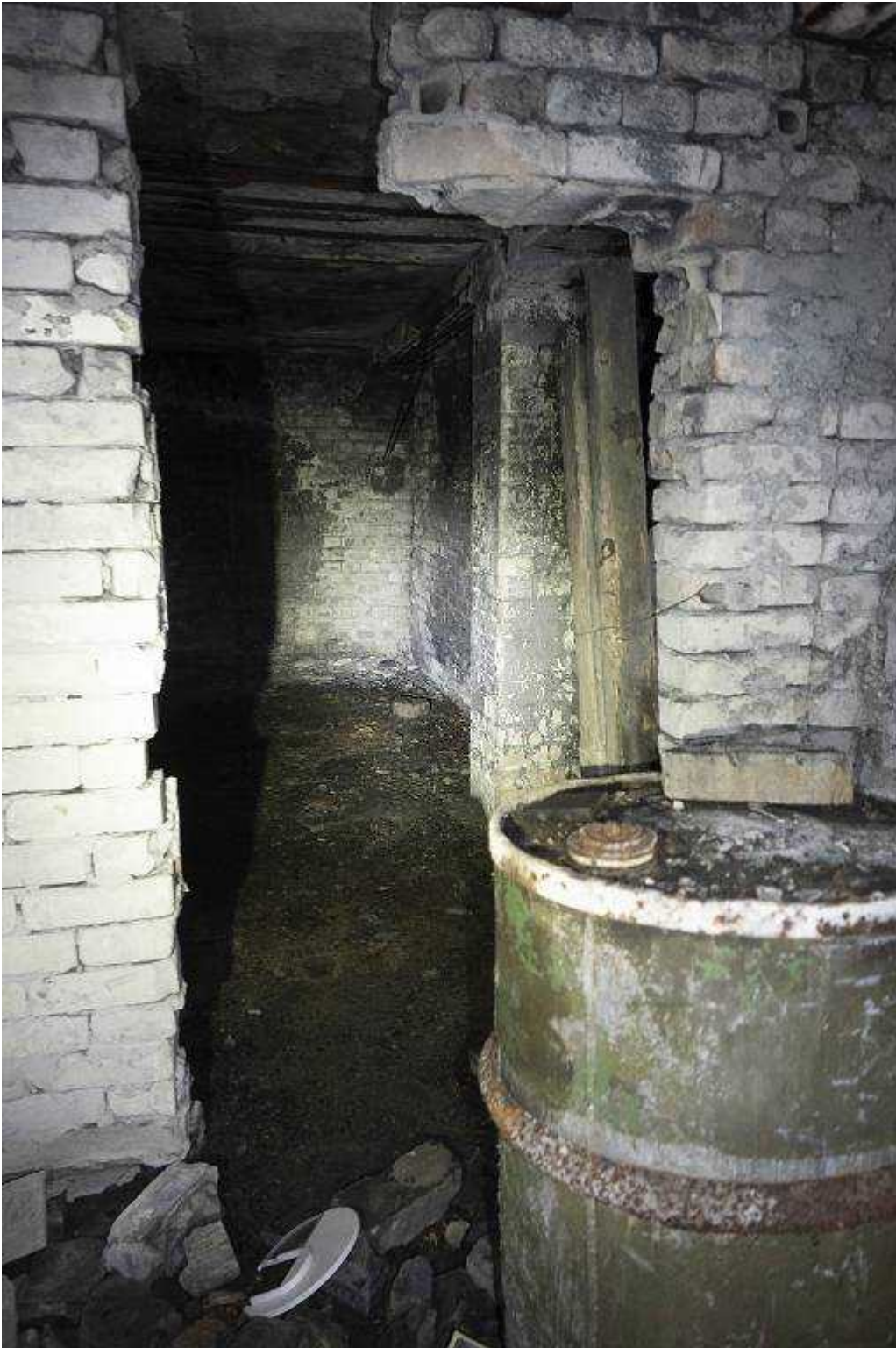
Abbildung 12 im Keller/Bunker: Alte Fässer (Altlasten)
