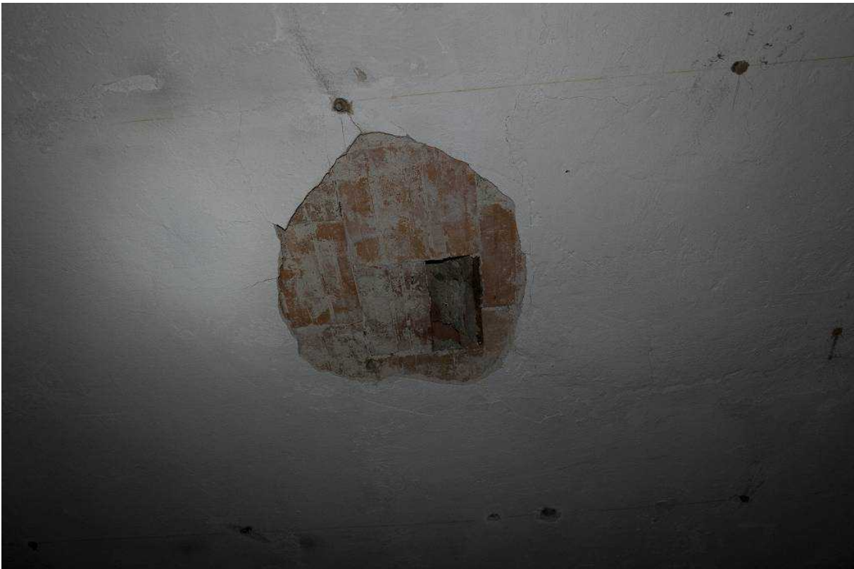
Abbildung 5 potenzielles Fledermausquartier in Decke (Gebäude 3)
