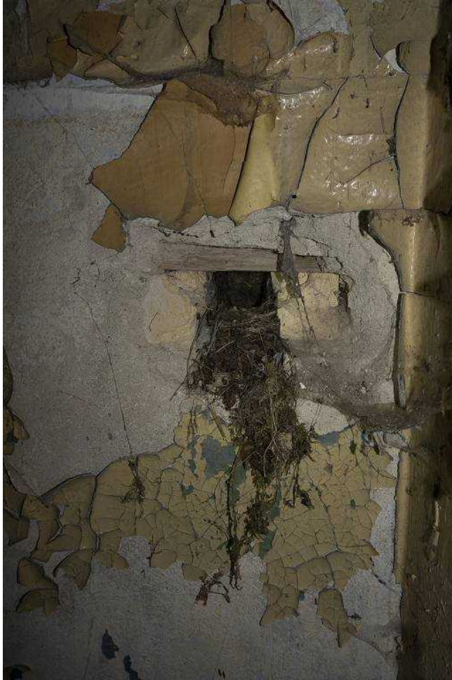
Abbildung 10 Vogelnest in Raum in Gebäude 3
